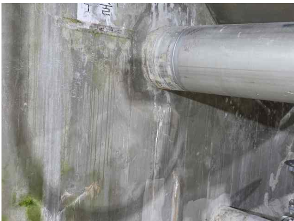
<유출밸브실 내부 벽체 균열부백태>
