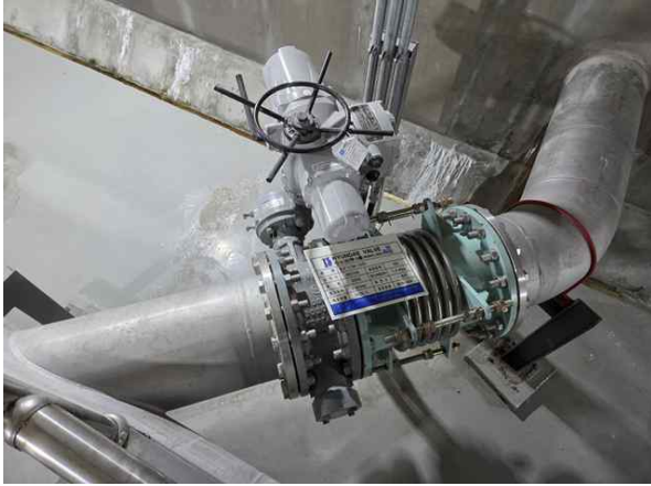
<유입 밸브, 배관, 볼트류 상태양호>
