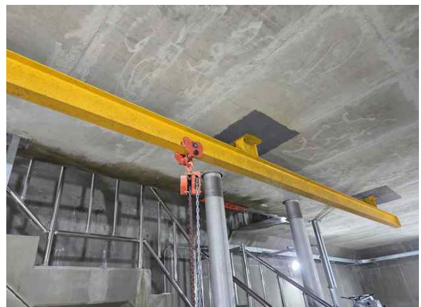
<레일 및 호이스트 상태양호>
