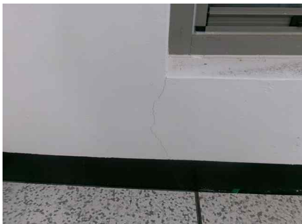
<전기실 내부 벽체 균열>
