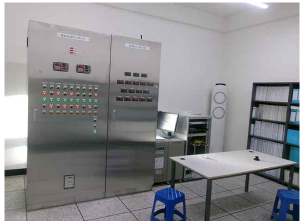
<전기실 내부 전경>
