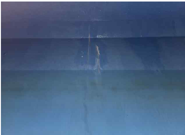
<2지 벽체 균열부백태>
