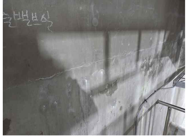
<유출밸브실 내부 벽체 균열(0.3mm미만)>
