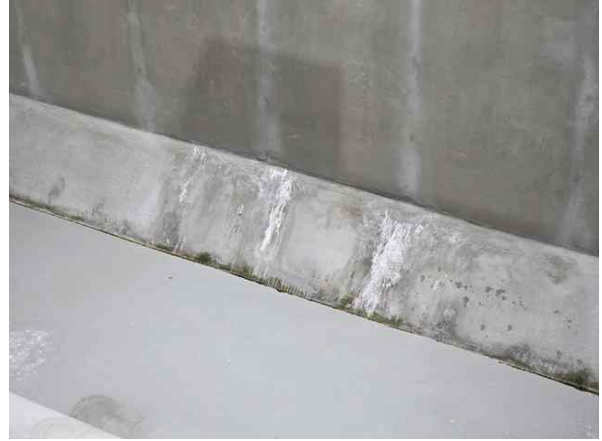
<유입밸브실 내부 벽체 백태>
