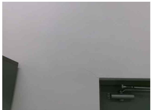
<전기실 내부 벽체 균열>
