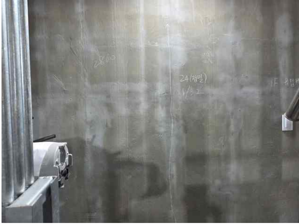
<유입밸브실 내부 벽체 균열(0.3mm미만)>
