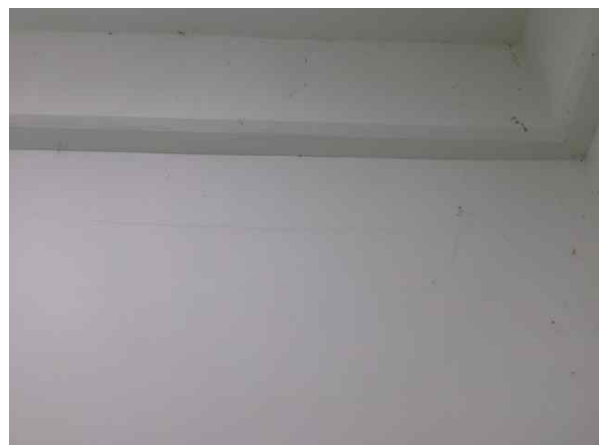
<배관검수실 내부 벽체 균열>
