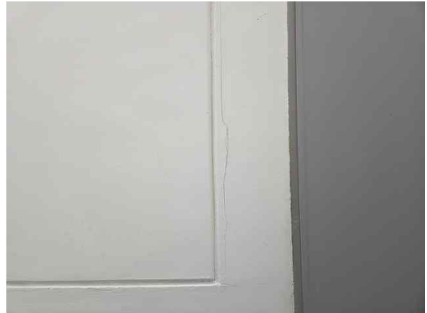
<검수실 내부 벽체 균열>
