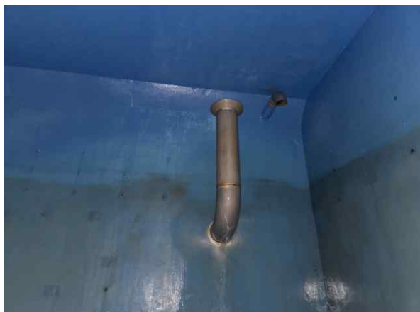
<2지 배관 유입관부식 상태양호>
