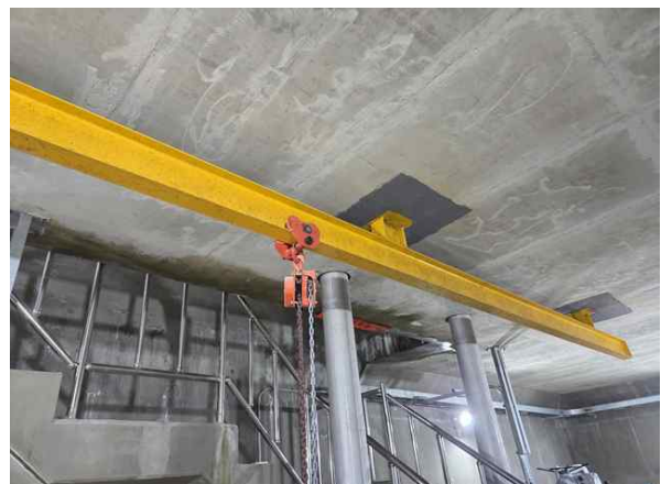
<레일 및 호이스트 상태양호>
