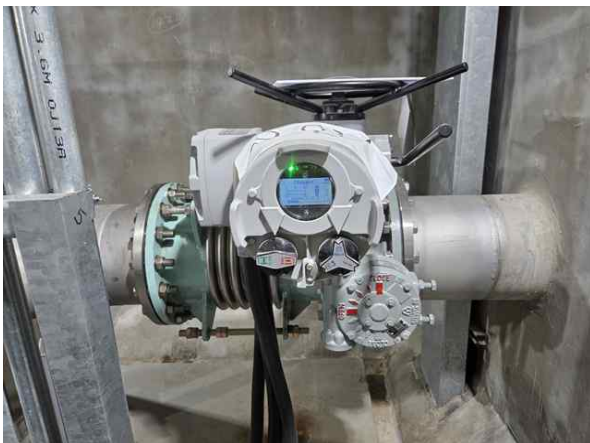
<유입 액츄에이터 상태양호>
