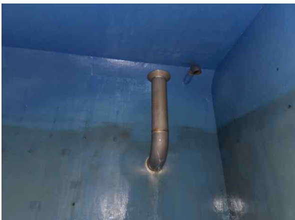
<2지 배관 유입관부식 상태양호>
