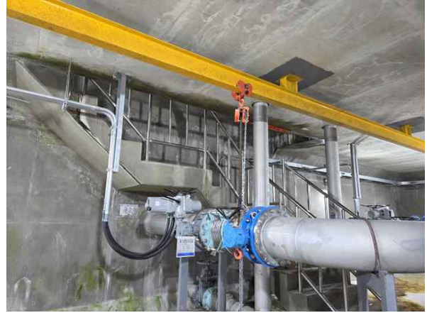
<유출 밸브, 배관, 볼트류 상태양호>
