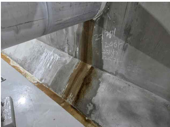
<유입밸브실 내부 벽체 누수, 누수백태>
