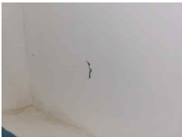
<검수실 내부 벽체 균열>
