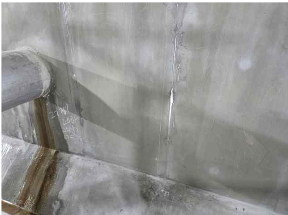
<유입밸브실 내부 벽체 균열부백태>
