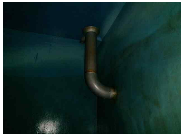
<1지 배관 유입관부식 상태양호>
