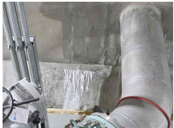
<유입밸브실 내부 벽체 균열부백태>
